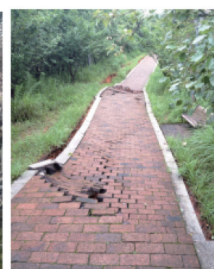
图 4 后缘裂缝损坏道路
